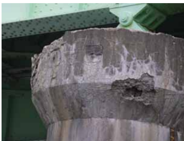
写真 3.14 地図状ひび割れが進行しはく離
