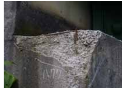
写真 1.3 ひび割れ部のはく離 が進行し鉄筋が露出 (劣化期の例)
