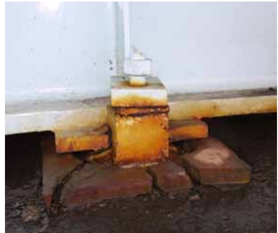
写真 3.21 支承モルタルの凍結膨張によるひび割れ
