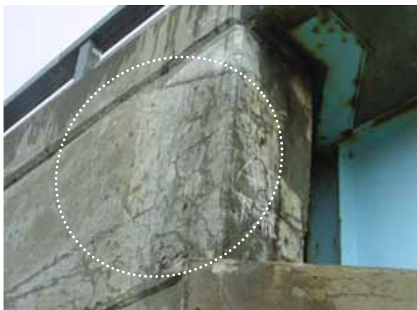
写真 3.12 ウイング側面の地図状ひび割れ
