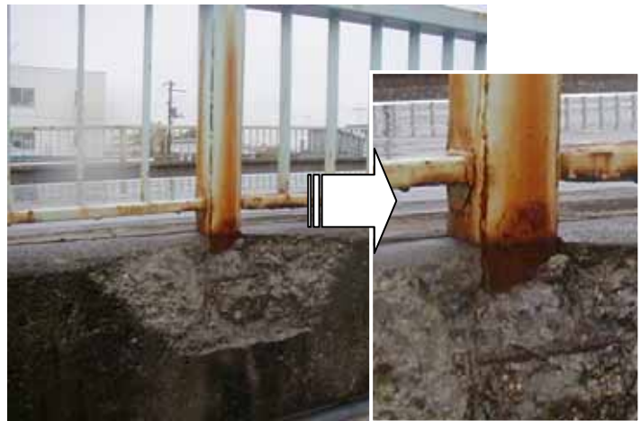
写真 3.20 防護柵支柱埋込み部の凍結膨張によるはく離、鉄筋露出
