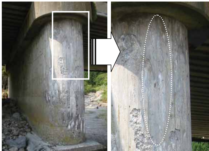
写真 3.16 橋脚柱側面のエフロレッセンスを伴う鉛直方向のひび割れ
