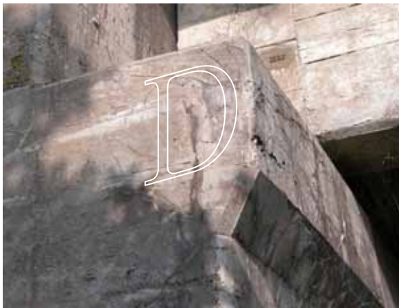
写真 3.8 橋台座部のDひび割れ
