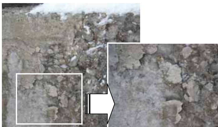
写真 3.3 橋台堅壁側面(日射有り)のスケーリング
