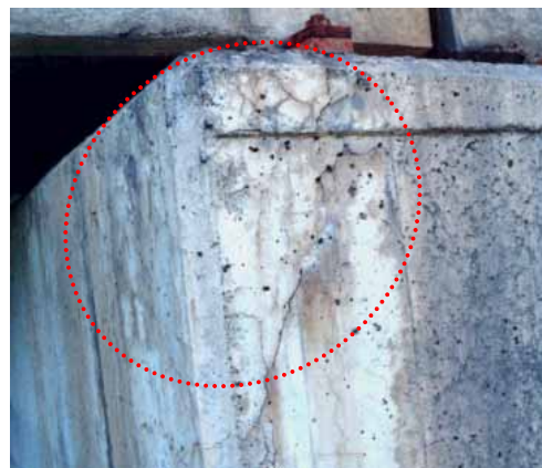
写真 3.13 コンクリート表面のひび割れ
