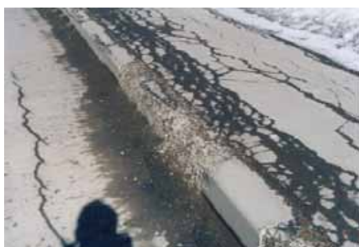
写真 3.4 スケーリングが進行している縁石 (プレキャスト2次製品)
