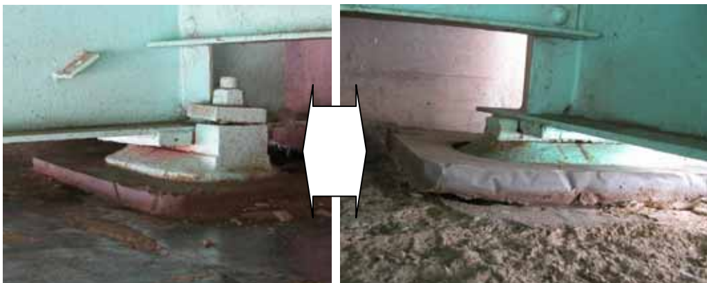
写真 3.22 沓座モルタル補修部の凍結膨張による変形
