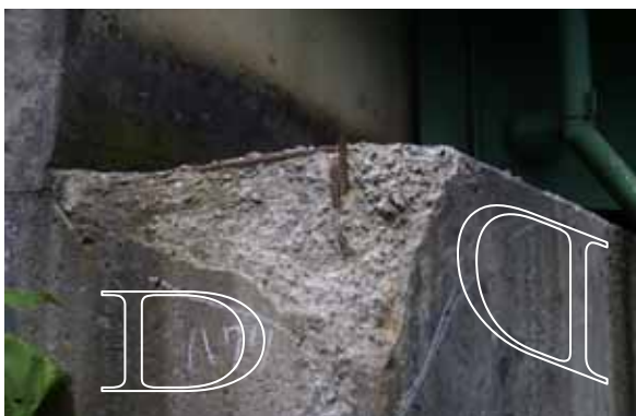
写真 3.10 橋台沓座のDひび割れが進行し鉄筋露出に到る
