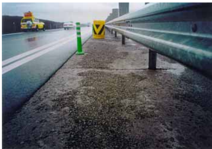
写真 2.1 分離帯（高規格幹線道路）コンクリートシールのスケーリング劣化状況
