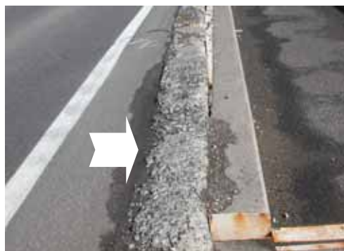
写真 3.5 スケーリングが進行し形状を留めない まで崩壊している地覆(現場打ちコンクリート)
