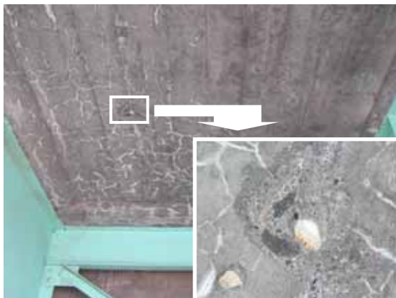
写真 3.17 鋼橋 RC 床版下面のポップアウト
