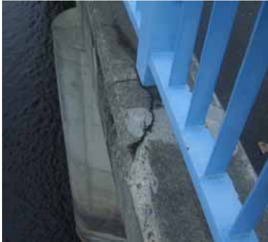
写真 3.19 防護柵支柱埋込み部の凍結膨張によるひび割れ
