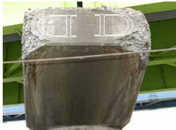
写真 3.9 橋脚梁端部のDひび割れが進行し断面欠損に至る
