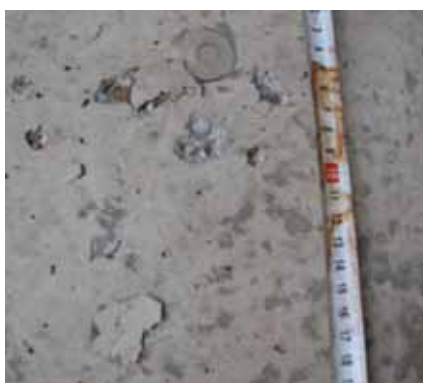
写真 3.2 橋台堅壁(日射無し)の スケーリング
