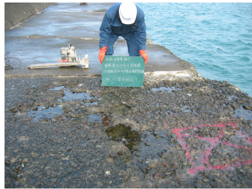
写真-1 スケーリングの一例 (A港, a1, 剥離度31mm)
