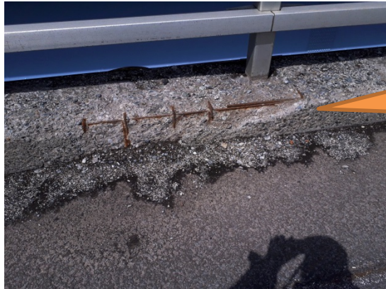
塩害によるスケーリングの状況(橋梁地覆)
