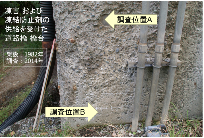
写真-1 道路橋橋台 調査箇所A:スケールリング発生箇所(剥離深さ約50mm) 調査箇所B:スケールリングが軽微で、外見上健全な箇所
