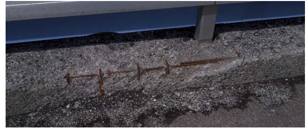
スケーリングが発生した道路橋地覆
