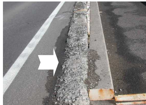
写真 3.5 スケーリングが進行し形状を留めない まで崩壊している地覆（現場打ちコンクリート）
