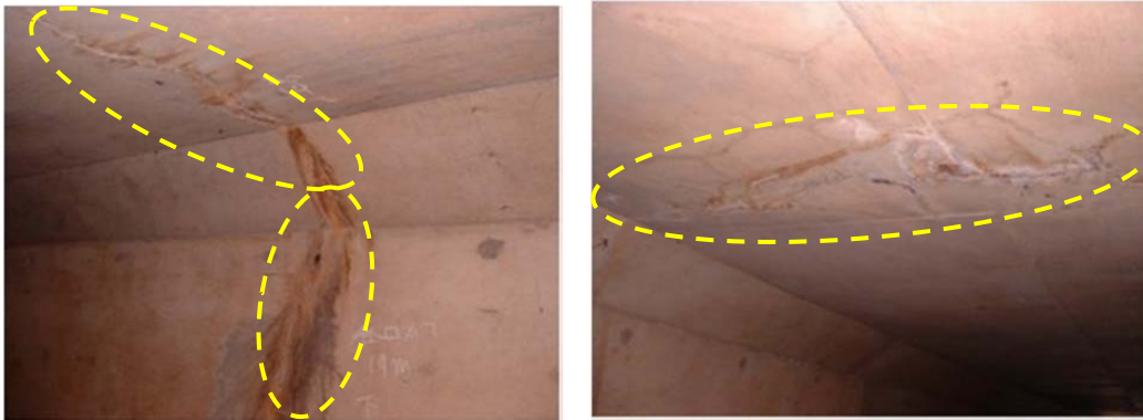
写真 函体の沈下によるひび割れ
