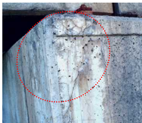
写真 3.13 コンクリート表面のひび割れ
