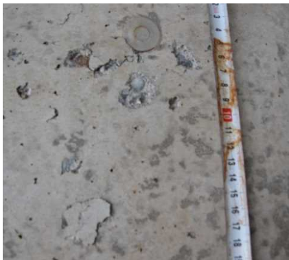
写真 3.2 橋台堅壁（日射無し）の スケーリング
