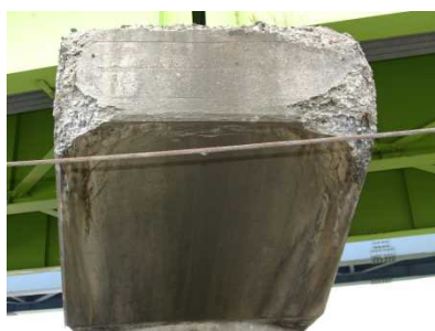
写真 1.2 ひび割れ部が はく離し骨材が露出 (加速期の例)
