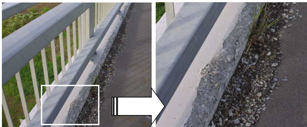
写真 3.6 地覆表面を凍害補修しているが、スケーリング再劣化している状態
