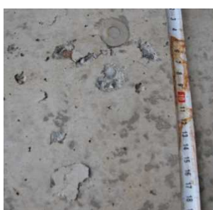
写真 1.1 スケーリングの発生 (進展期の例)
