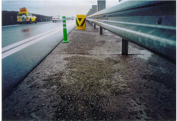
写真 2.1 分離帯（高規格幹線道路）コンクリートシールのスケーリング劣化状況
