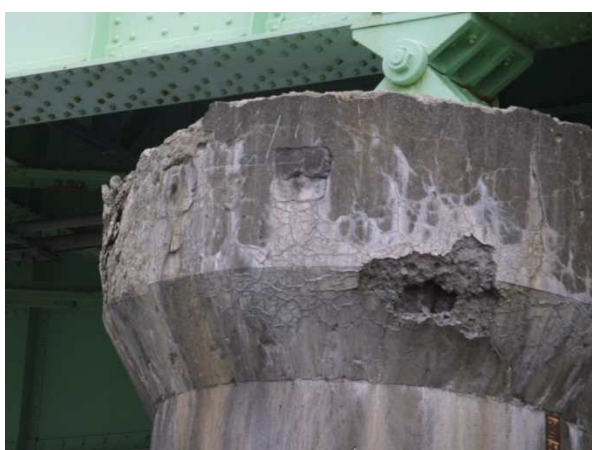
写真 3.14 地図状ひび割れが進行しはく離
