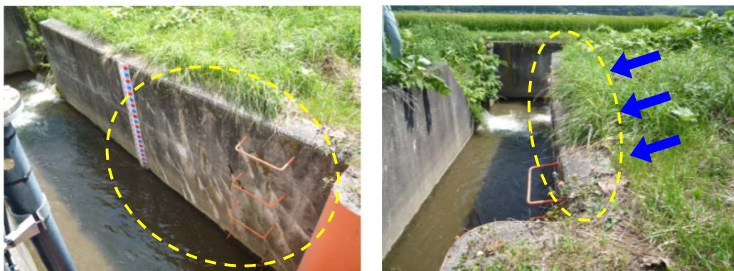
写真 翼壁の土圧によるひび割れ
