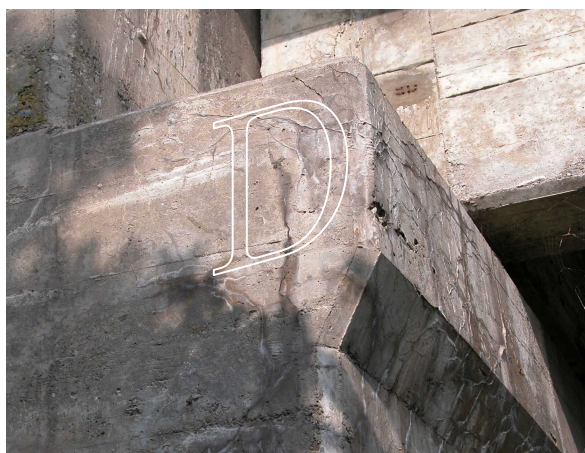
写真 3.8 橋台座部のDひび割れ
