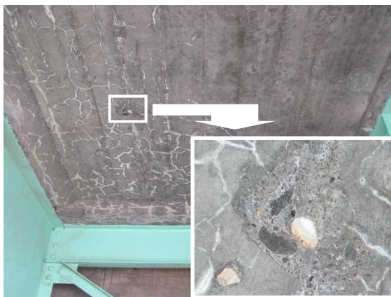
写真 3.17 鋼橋 RC 床版下面のポップアウト
