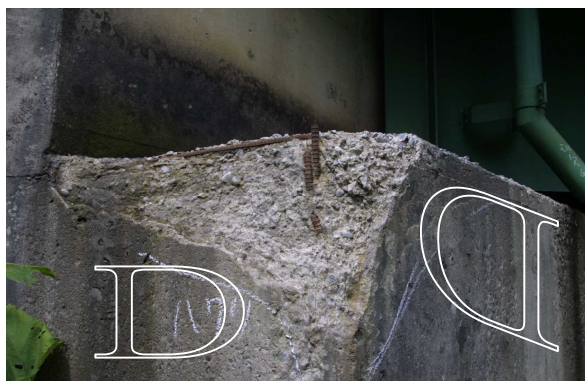
写真 3.10 橋台沓座のDひび割れが進行し鉄筋露出に至る
