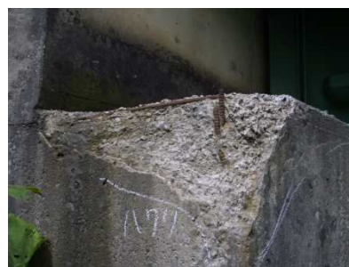
写真 1.3 ひび割れ部のはく離 が進行し鉄筋が露出 (劣化期の例)
