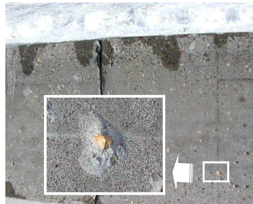
写真 3.18 海岸擁壁表面のポップアウト
