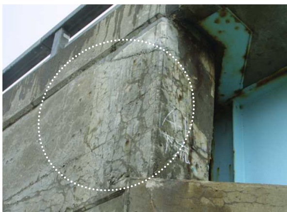
写真 3.12 ウイング側面の地図状ひび割れ
