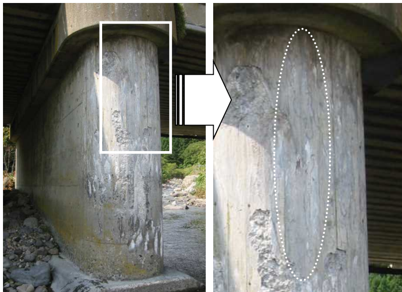
写真 3.16 橋脚柱側面のエフロレッセンスを伴う鉛直方向のひび割れ
