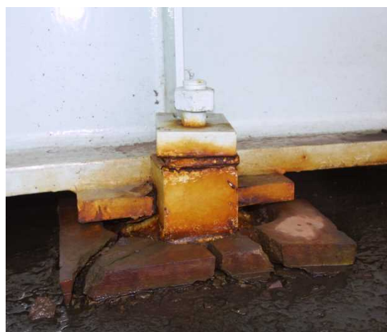
写真 3.21 支承モルタルの凍結膨張によるひび割れ
