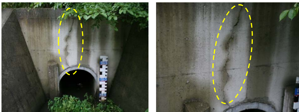
写真 乾燥収縮によるひび割れ
