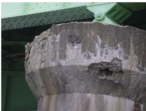
写真 3.14 地図状ひび割れが進行しはく離
