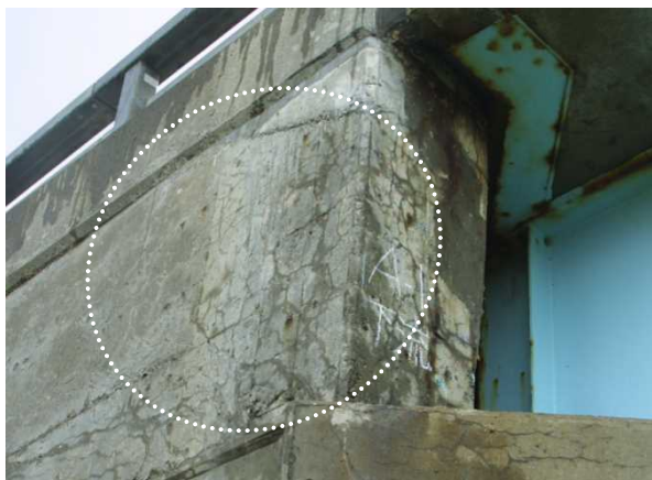
写真 3.12 ウイング側面の地図状ひび割れ
