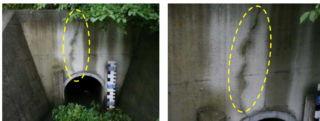
写真 乾燥収縮によるひび割れ
