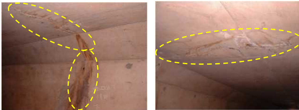
写真 函体の沈下によるひび割れ
