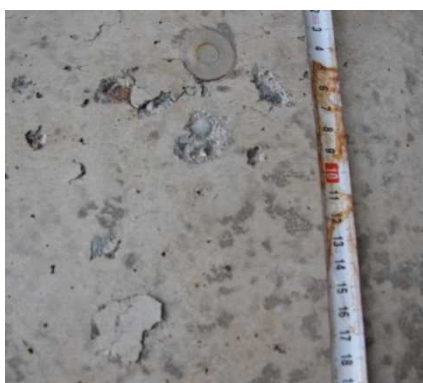
写真 3.2 橋台堅壁（日射無し）の スケーリング
