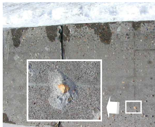
写真 3.18 海岸擁壁表面のポップアウト
