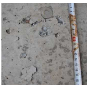
写真 1.1 スケーリングの発生 (進展期の例)
