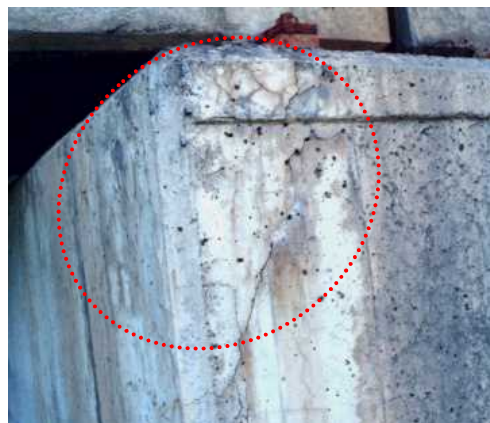
写真 3.13 コンクリート表面のひび割れ
