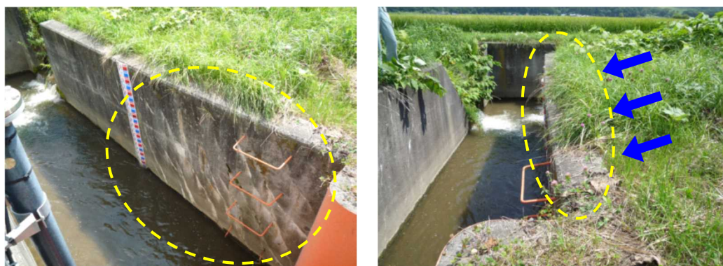
写真 翼壁の土圧によるひび割れ
